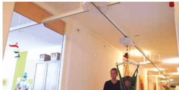
Monorailsysteem met rotonde en brandwerende deurdoorvoer.
