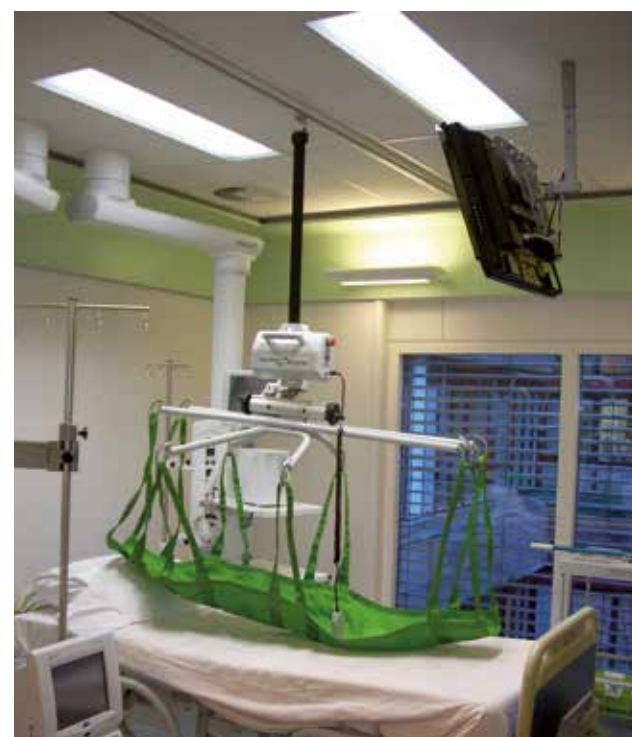
Multirail motor horizontaal tillen en monorail op intensive care.
