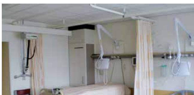
Ziekenhuiskamer meerbeds met traverse-systeem voorzien van gordijndoorvoer.
